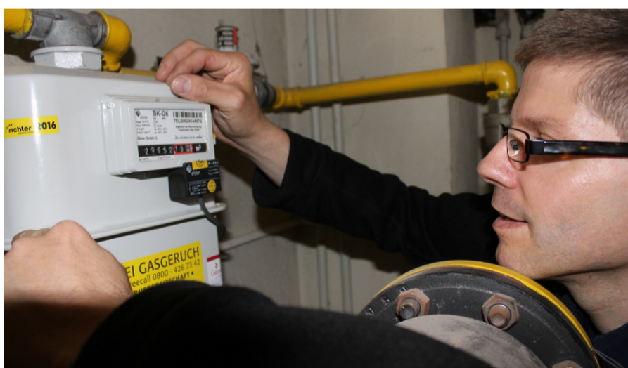
Haustechniker René Lüdtké (35) liest in regelmäßigen Abständen den Zählerstand beim ankommenden Gas im Technikraum des Hotel Baltic ab. © mbb
